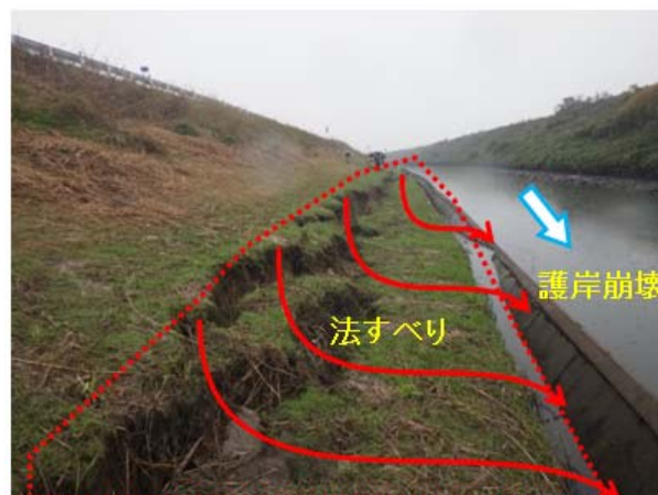
災害発生状況
