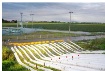
関東・東北豪雨での支援状況 (排水ポンプ車による排水活動 大崎市 H27.9)
