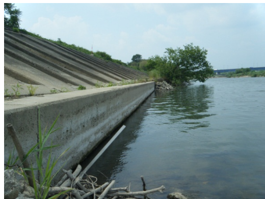
■ 既設護岸被災状況
