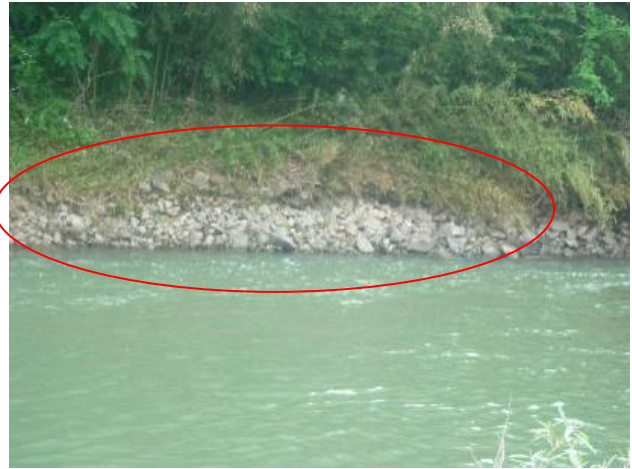
■ 既設護岸被災状況
