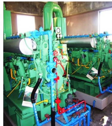
予備発電設備の更新
