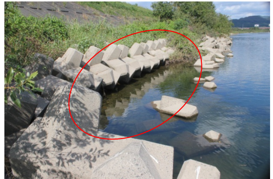
■護岸損傷状況(豊島地区)
