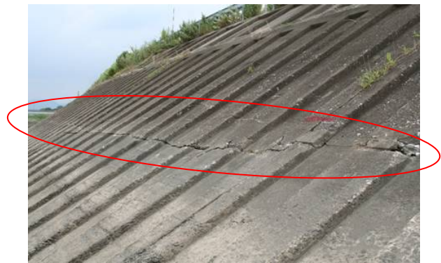
■護岸老朽化状況
