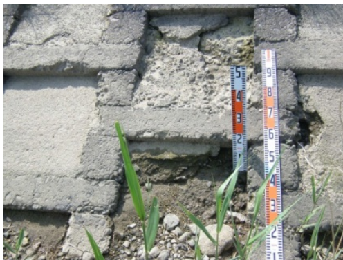
■護岸損傷状況
