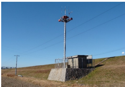
豊川放水路 放流警報設備
