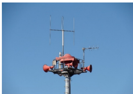
サイレン、スピーカー
