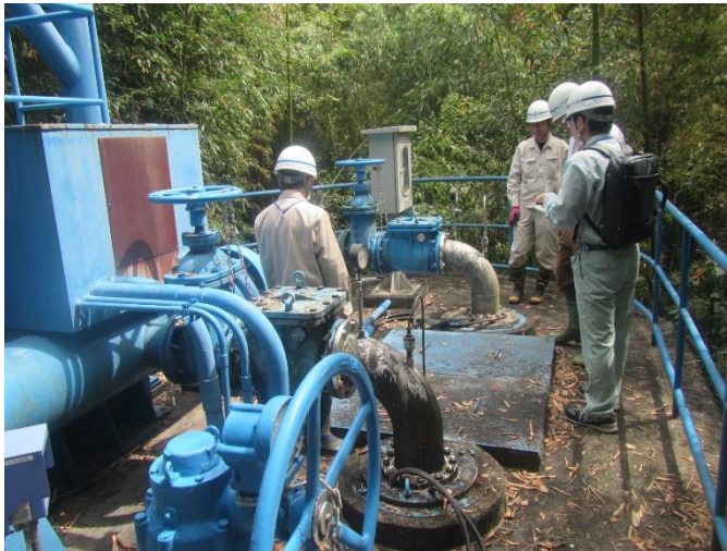
令和6年度 出水期前点検の様子（許可施設管理者との合同点検）
