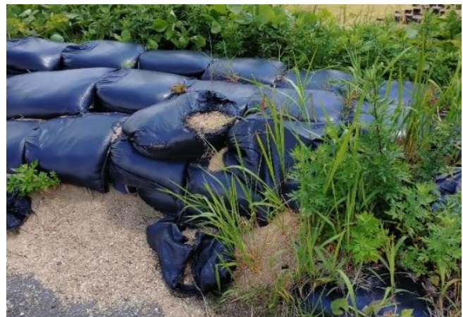
③一部破損も見られた黒の土嚢袋
