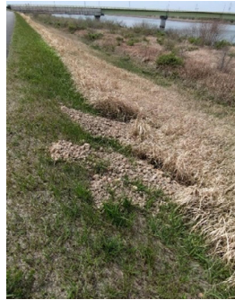
左岸6km付近コンクリート瓦礫の不法投棄があった。
