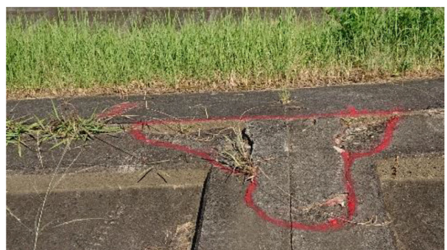
③ ひび割れたした護岸壁を、赤枠でチェック (右岸15Km付近)
