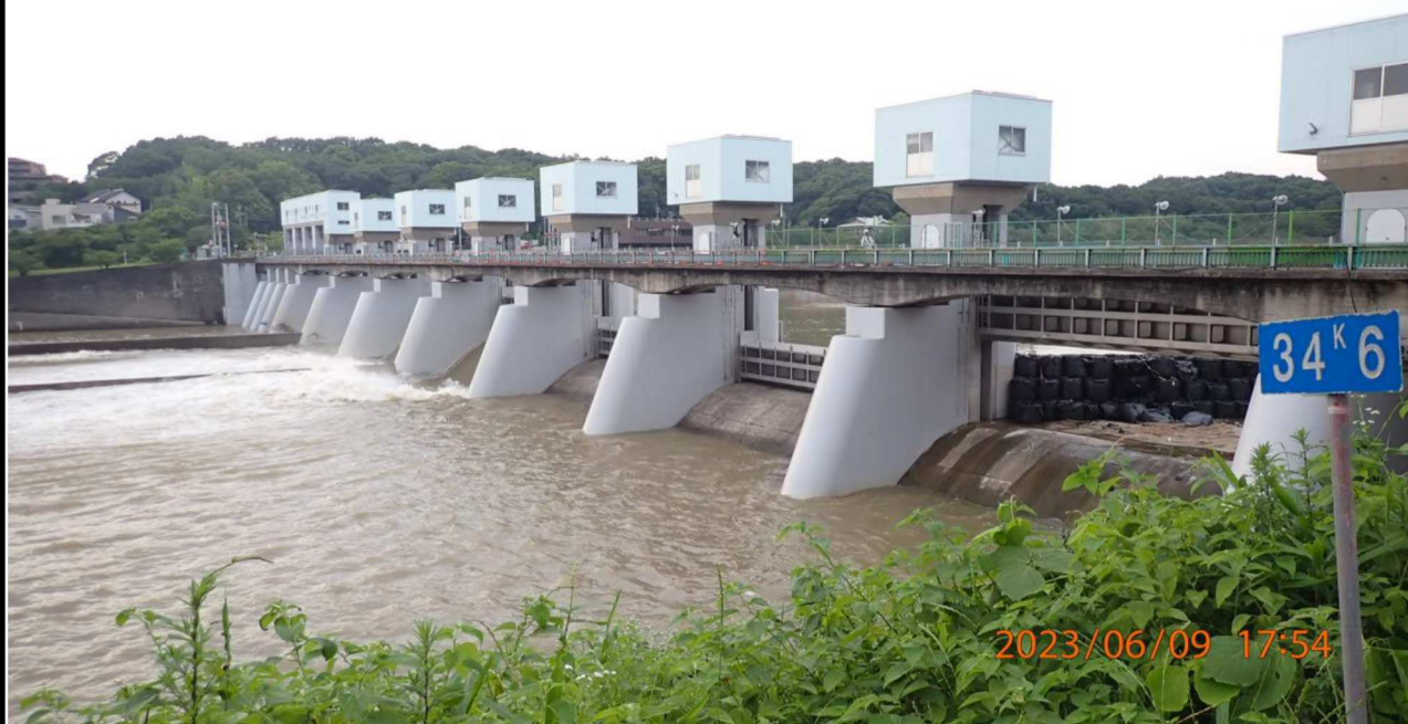
水源橋付近の様子（2）左岸34.6km付近より水源橋を撮影。 水源橋（左岸）上流側に堰が見える。
