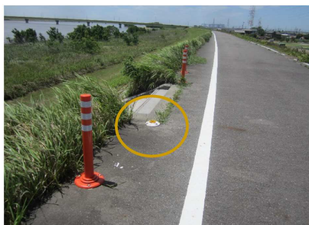
右岸3.8km付近から下流方向撮影 ポールの欠損
