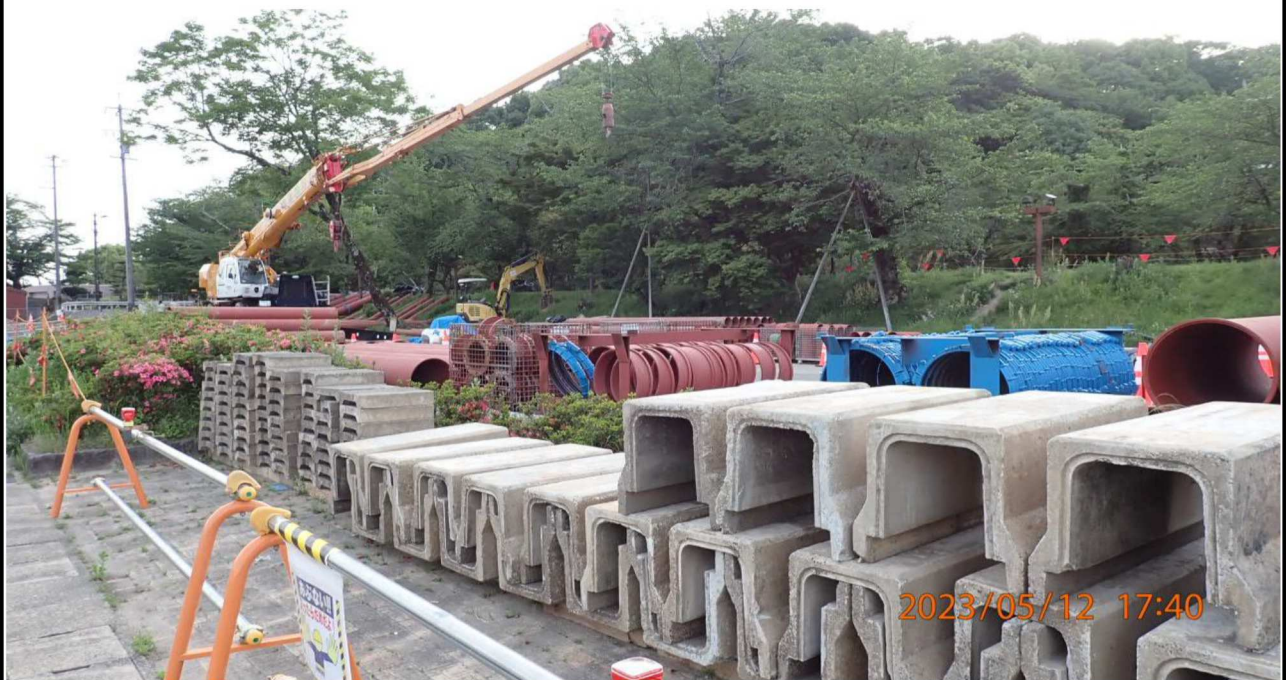
水源公園付近の様子（2） 工事用の資材が多く置かれていた。
