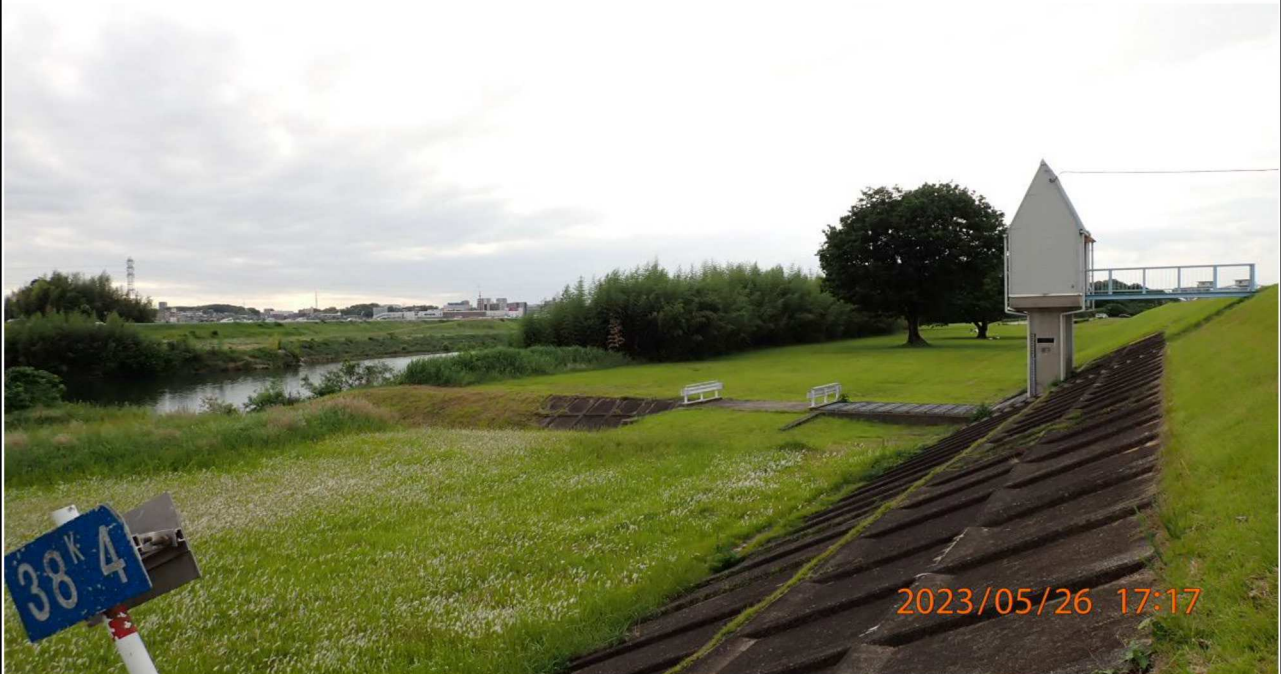
御立排水ひ管付近の様子（1）左岸38.4km付近より上流を撮影。
