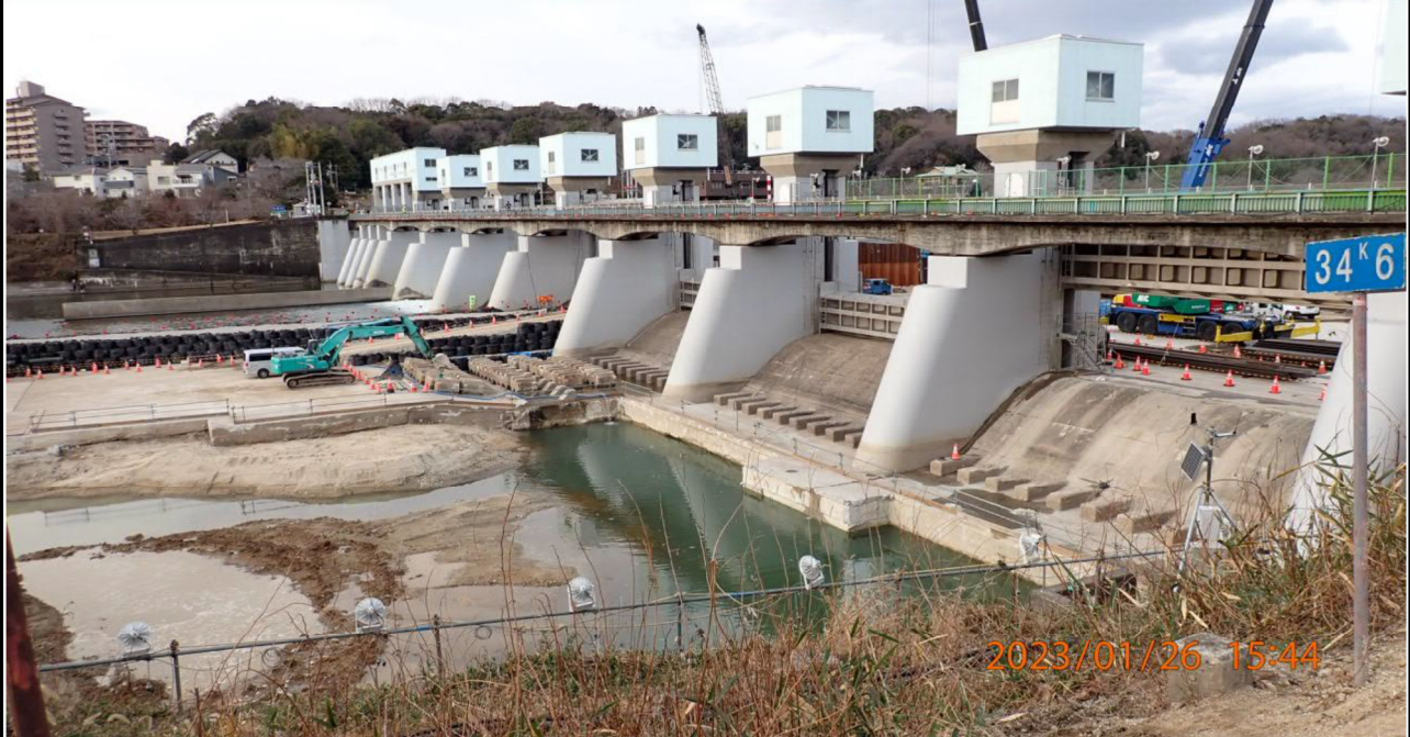
水源橋付近の様子（1） 水門の一部を閉ざして工事が行われていた。
