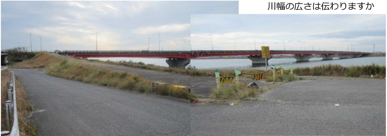
2.2km地点 小栗排水ひ管の設置状況 堤防を横断して矢作川に排水している
