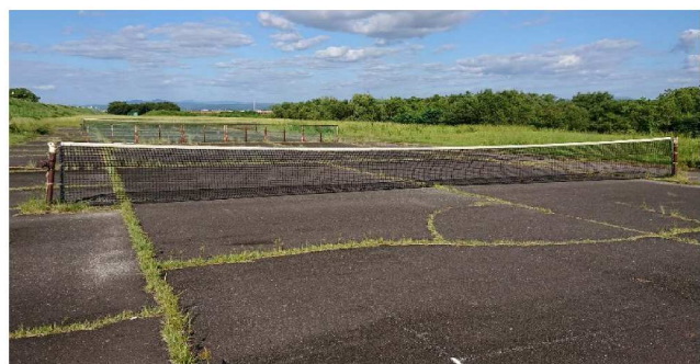
④ テニスのハードコートが2面 ひび割れも
