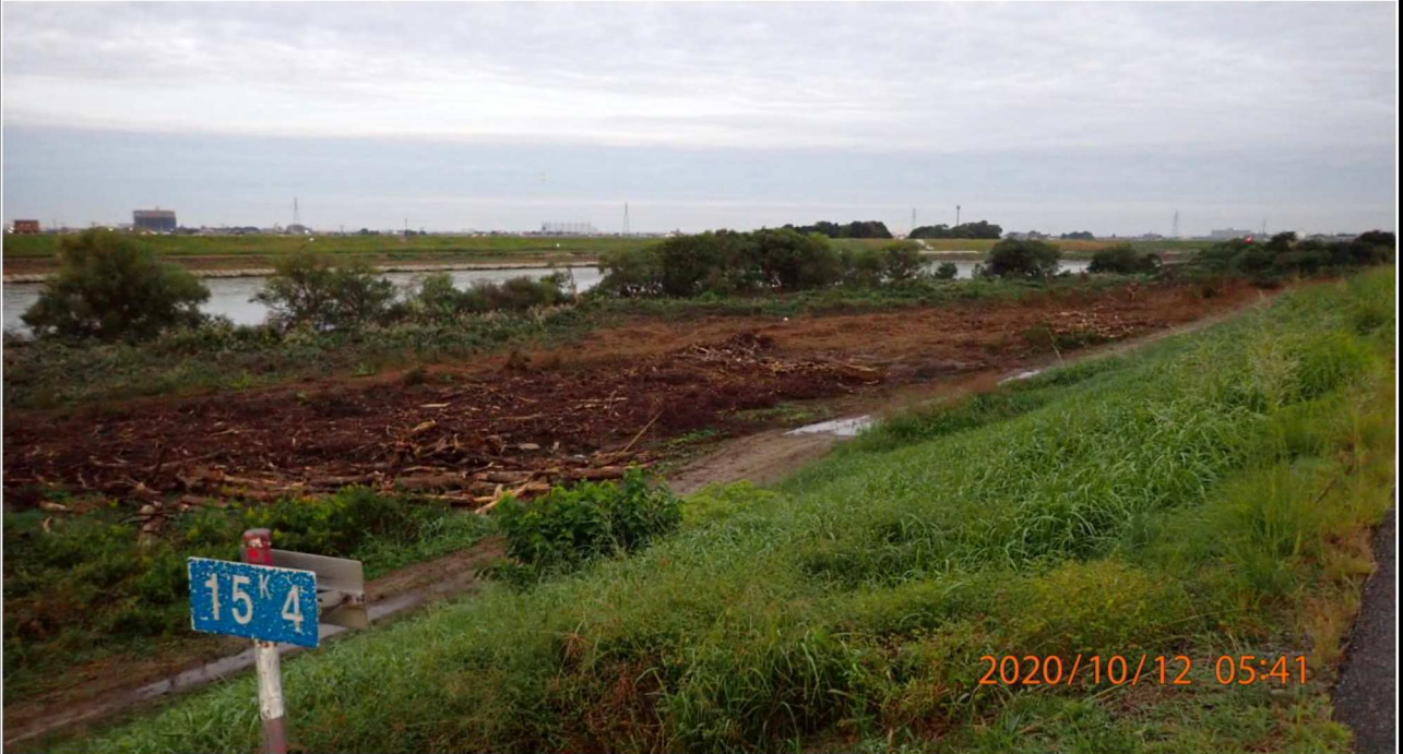
左岸15.4km付近より上流を撮影。伐採された木々が見える。
