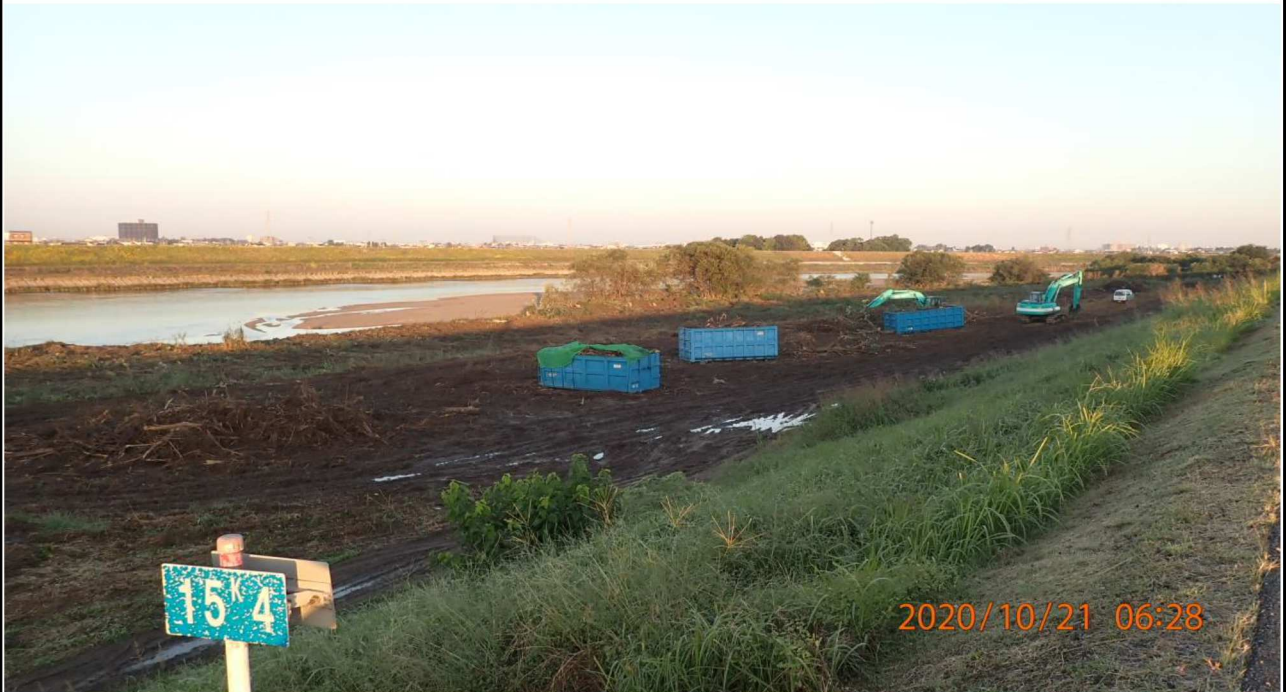
左岸15.4km付近より上流を撮影。伐採された木々を回収中の様子。
