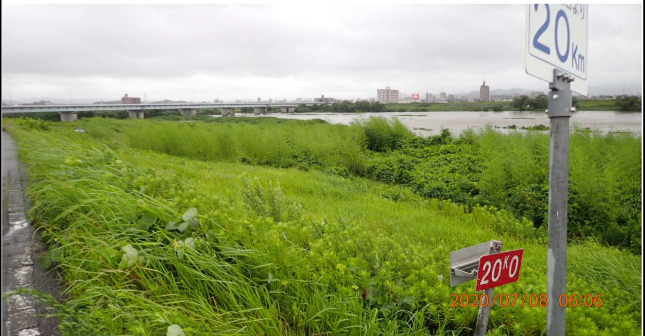
右岸20km付近より上流を撮影。雑草が多く茂っている。
