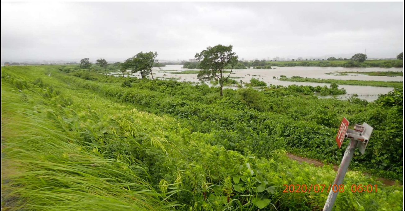
右岸19km付近より上流を撮影。雑草の繁殖と増水がよくわかる。
