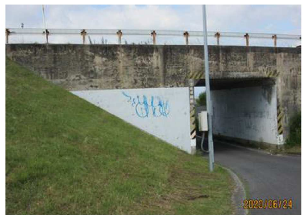
殆どの立体交差部のトンネル部内部、側面の落書き 【上塚橋、中畑橋、矢作川大橋】
