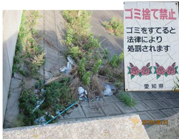
【左岸河口部】堤防背面で禁止看板の裏側にゴミ捨て
