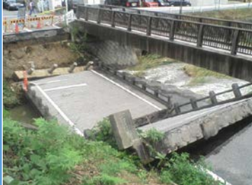
竜泉寺川三河橋の落橋(岡崎市菟川新町)
