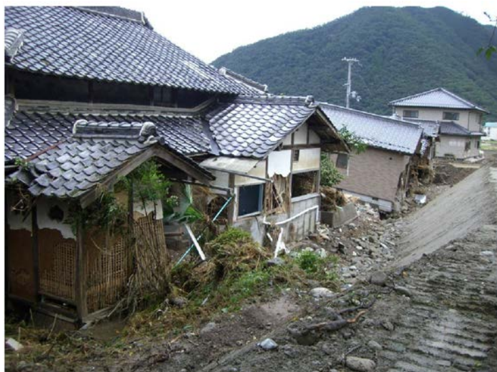
河川沿いの住家の被害状況
