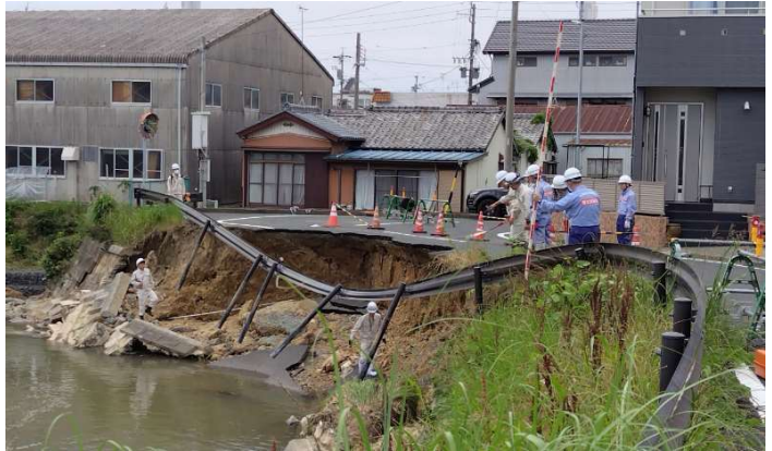
②山中川の被災状況調査
