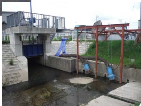
福岡玉川地区: 内水排除ポンプ
