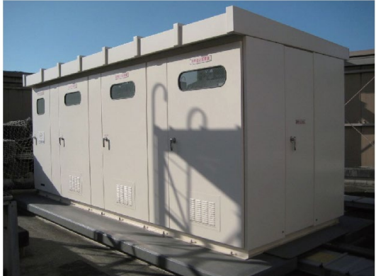
▲変電設備や配電盤(非常用切替盤)等の重要設備を屋上に配置
