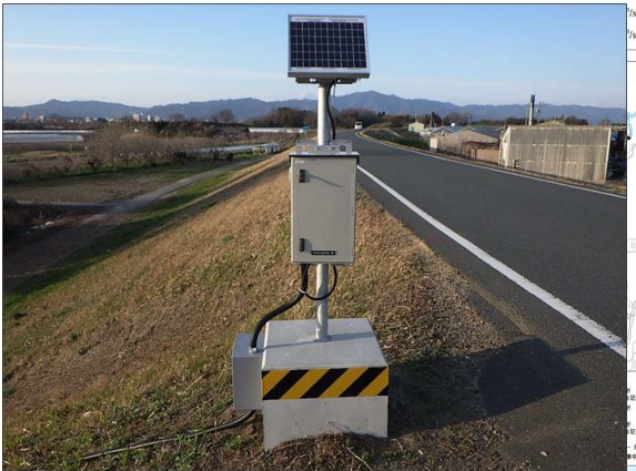
危機管理型水位計の外観
