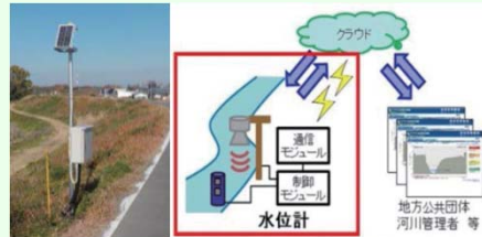
危機管理水位計の設置
