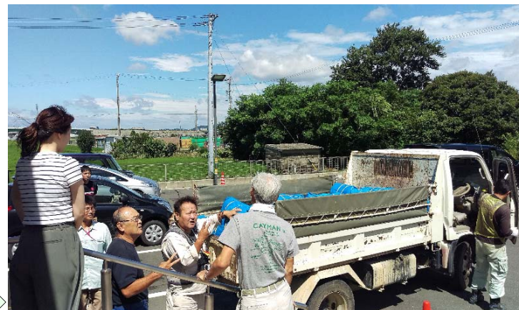
豊橋河川事務所職員、豊橋市職員で協力しての荷下ろし作業
