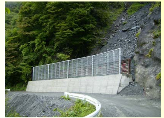
落石防護対策
