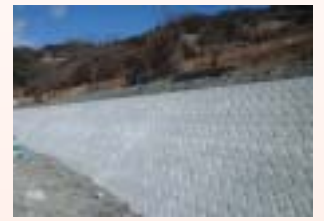
ブロック張 コンクリートブロックを積みながら裏側にコンクリートを充填します。表面を現地土砂でゆるやかに覆います。
