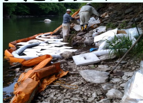
H30.6 水質事故現場
