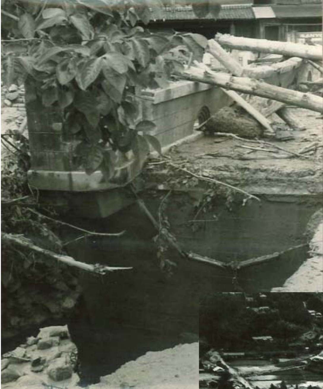
▲ひつじ満水（1715年）の再来といわれる鉄砲水にヒン曲げられた野底橋
