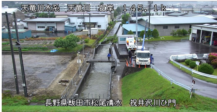
■飯田市 排水ポンプ車 設置状況
