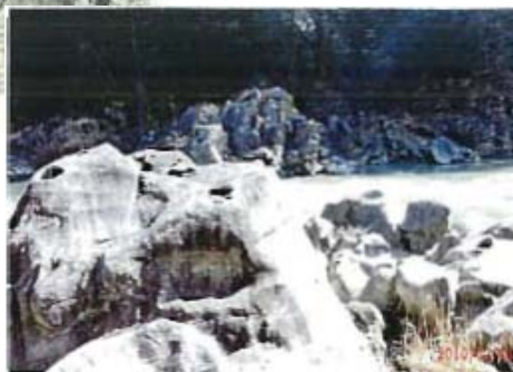
橋柱の穿孔跡
