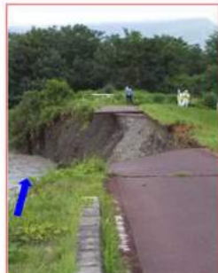
●伊那市【三峰川右岸4.6kp付近】 (堤防の欠損)
