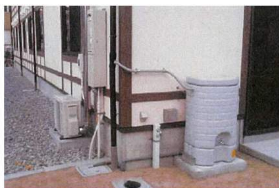
雨水貯留タンク (兵庫県 HP)
