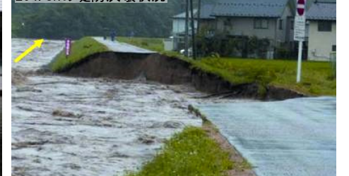
204.8kの堤防決壊状況
