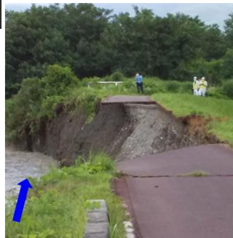
令和2年 三峰川 堤防欠損
