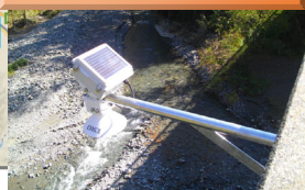
水位計設置例 (下図は⑥常盤橋)
