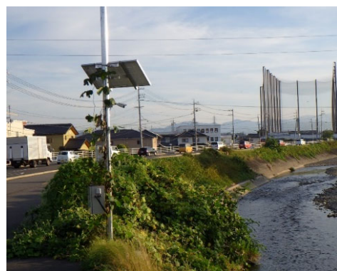
簡易型河川監視カメラ
