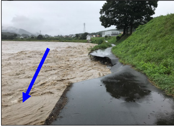
8月15日10:00 管理用通路の欠損状況
