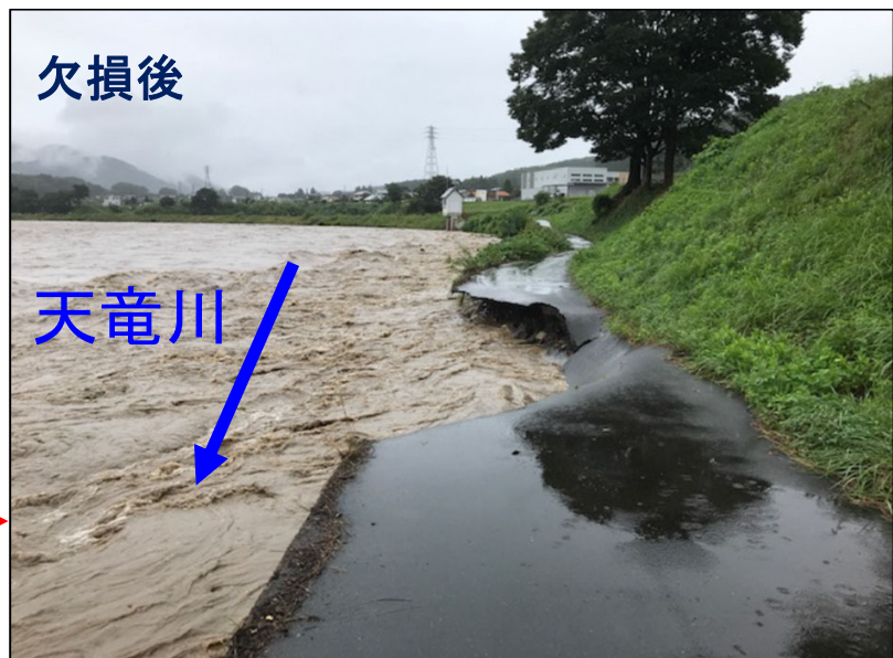
R3.8.15撮影 上伊那郡辰野町樋口地先(天竜川左岸208.2kp付近)にて管理用道路の欠損が発生
