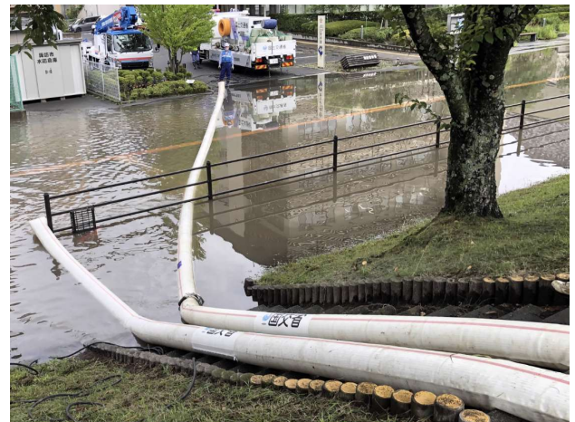
排水ポンプ車の稼働状況
