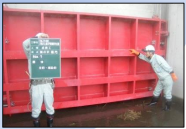
機械設備点検
