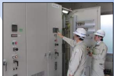
通信設備点検
