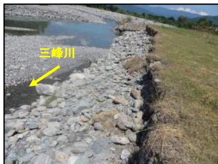
H30.7月 出水 三峰川の法面侵食
