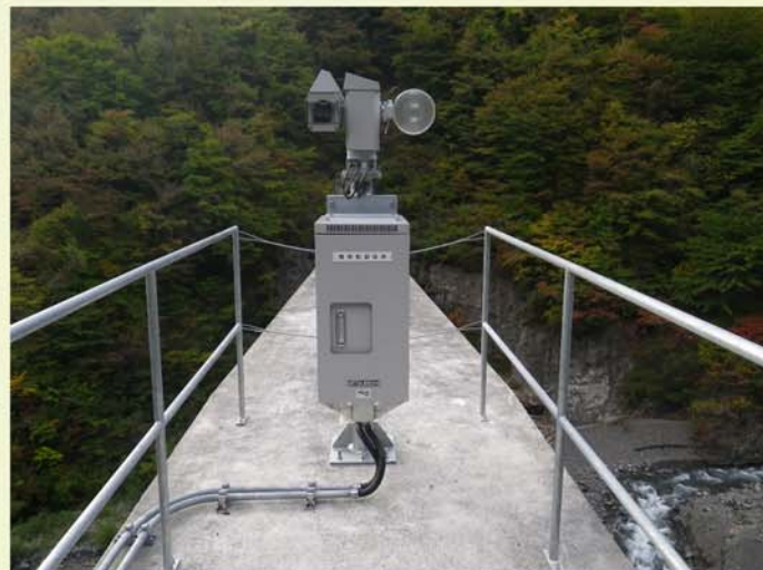
土石流発生状況等を監視するカメラ
