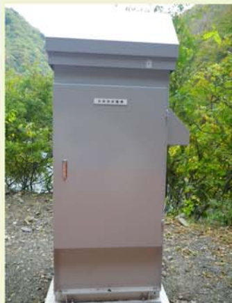
停電時自動で起動する非常用発電機
