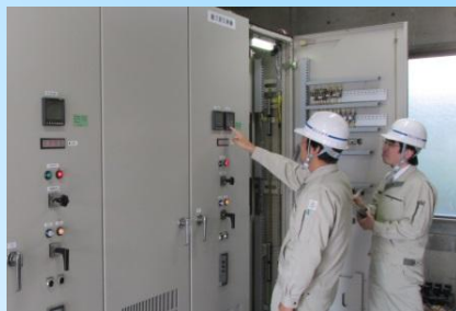
通信設備点検
