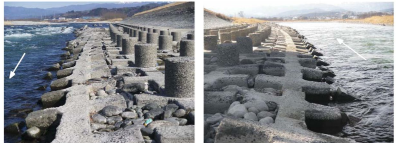
写真 2-1 根固めブロックの変形状況
