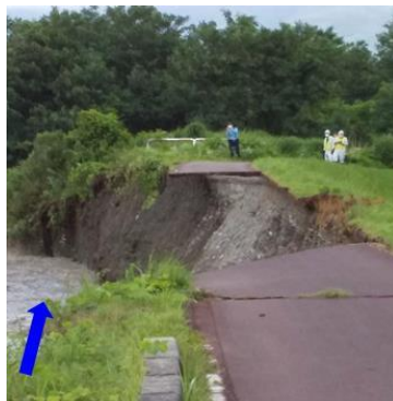
令和2年 三峰川 堤防欠損
