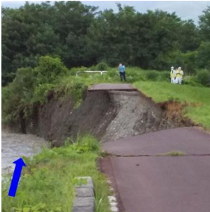
令和2年 三峰川 堤防欠損
