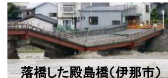
落橋した殿島橋(伊那市)
